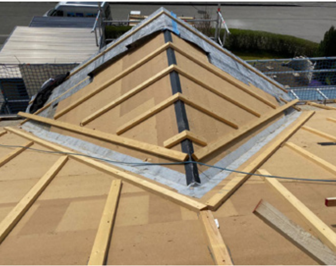
Abdichtung in der wasserführenden Ebene...
