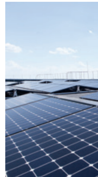
eine Photovoltaikanlage, die das Gebäude mit Energie versorgt.
