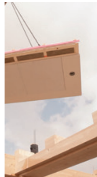
Im Juli 2014 begannen die Bauarbeiten am K8, dem neuen Firmensitz der Firma KAMPA.
