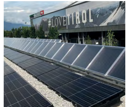
Solaranlagen der IIG
