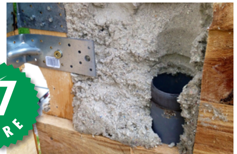
...keinerlei Spuren von Setzung oder Verformung auf.
