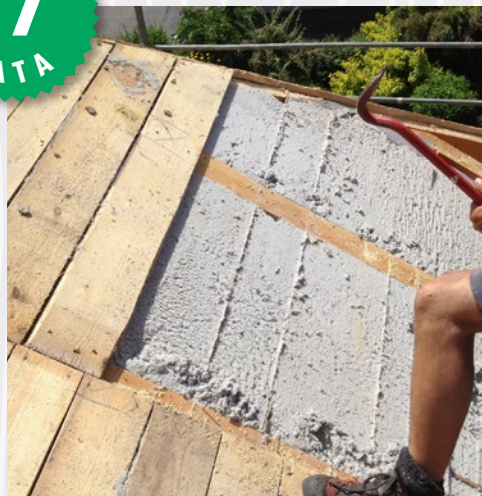
Konstrukcja dachu otwarta po 17 latach (dom w tyrolu) Celuloza ISOCELL funkcjonuje tak, jakby była świeżo
