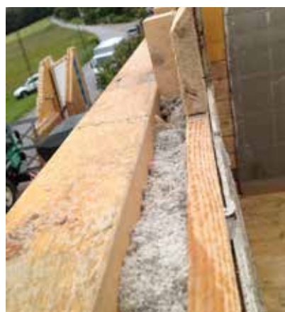
Die in den Außen- und Zwischenwänden zur Dämmung eingebrachte Zellulose wies nach 21 Jahren
