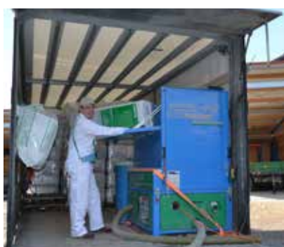
Eine starke Maschine im LKW befördert das Material durch den Schlauch bis zu den vorgefertigten Hohlräumen.
