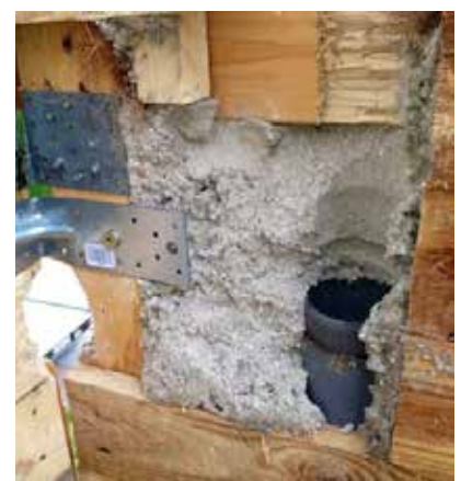
keinerlei Spuren von Setzung oder Verformung auf.
