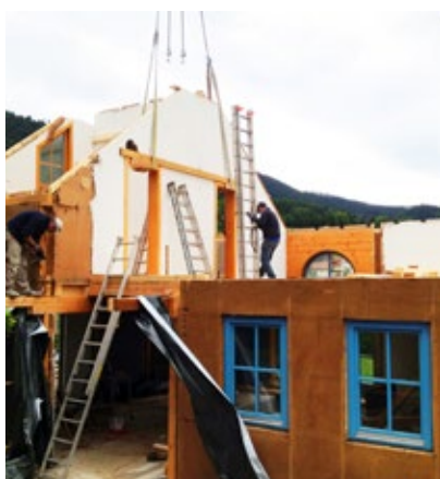
Po 21 letech byl demontován prefabrikovaný dům. Při rozebírání se zřetelně ukázalo, že:
