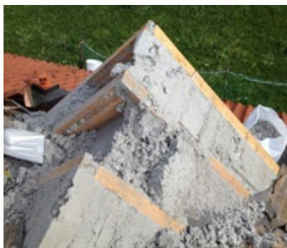
Nepoškozená a čistá celulóza po 17 letech...
