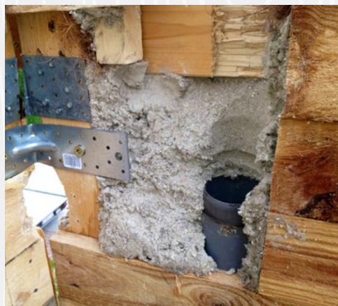
Celuloza wdmuchnięta jako izolacja ścian szkieletowych nie wykazuje nawet po wieloletniej eksploatacji jakichkolwiek oznak osiadania czy deformacji
